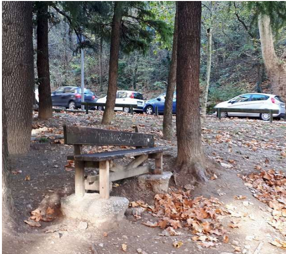
Foto 7: panchina con fondazioni esposte per dilavamento della terra sottostante
