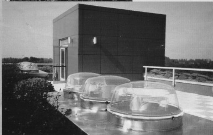
Pannelli fotovoltaici (a sinistra) e camini di luce (sotto) nella nuova sede della Nuncas, a Settimo Milanese
